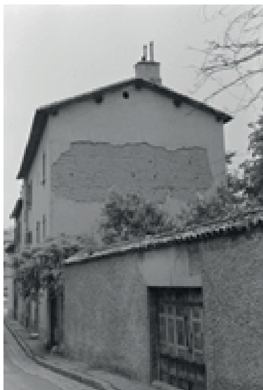
Immeubles de grande hauteur dont le mur aveugle à l'enduit abimé révèle le pisé, Lyon, quartier de la Croix-Rousse. Photo A.-S. Cléménçon, 2017
