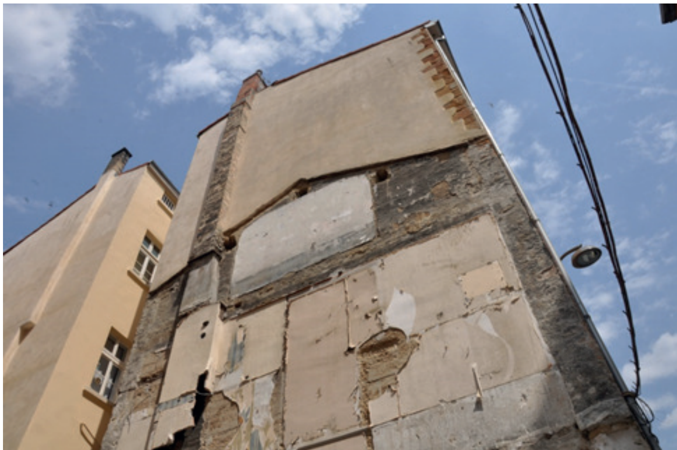
Immeubles de grande hauteur dont le mur aveugle à l'enduit abimé révèle le pisé, Lyon, quartier de la Croix-Rousse. Photo A.-S. Cléménçon, 2017
